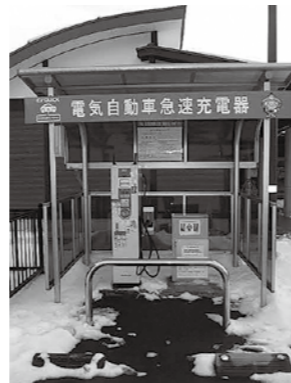
自動車充電インフラ整備
